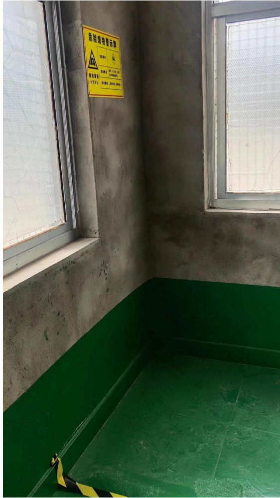
图 3.2 项目危废暂存间
