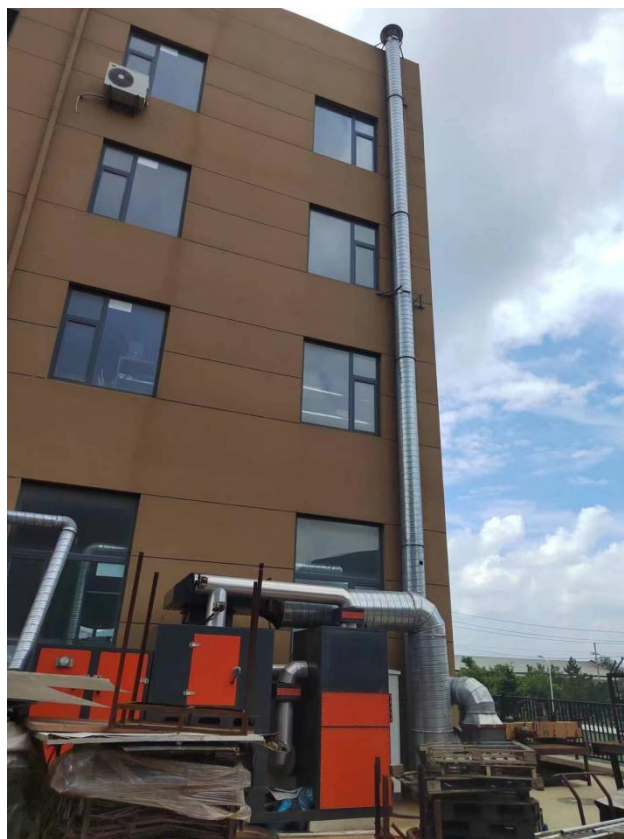
图 3-1 废气处理装置及排气筒
