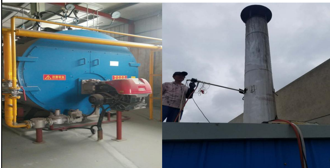
图 4.1 天然气锅炉及烟囱
