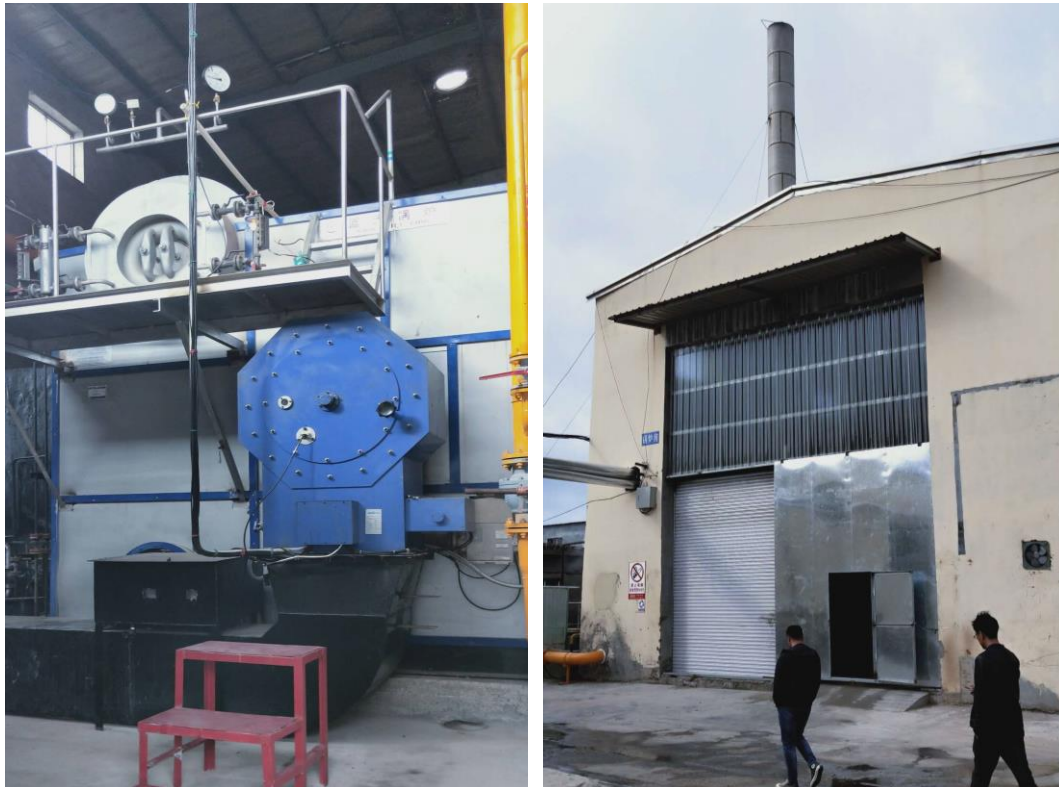
图 3-1 1 台 20t/h 的燃气锅炉及排气筒
